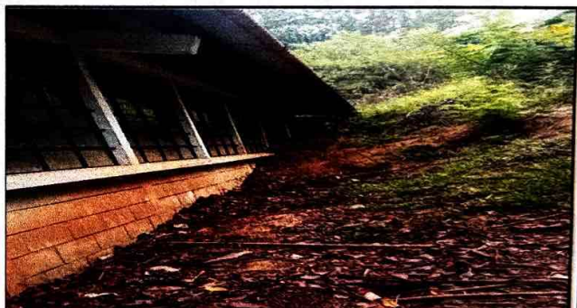
Foto 4: Se observa que el aula no. 2 tiene una sobre carga del 50% del peso total de la tierra soterrada.
