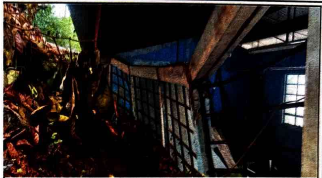
Foto 2: se observa que la pared, tiene una sobrecarga de tierra, que necesita ser removida.
