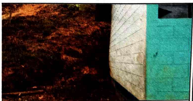
Foto 6: se observa que urge remover la tierra, reforzar el muro de contención y evitar que la entrada del invierno, provoqe más daños a la infraestructura.
