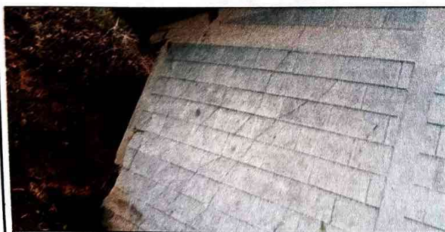
Foto 5: se observa, que las paredes de atrás de la escuela se están debilitando en su estructura, se puede evitar el colapso, a traves de la pronta y urgente acción.
