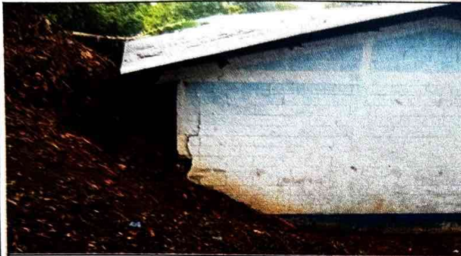
Foto 1: Se observa que la escuela quedo soterrada con varias toneladas de tierra, el alud, supero el muro de contención existente.
