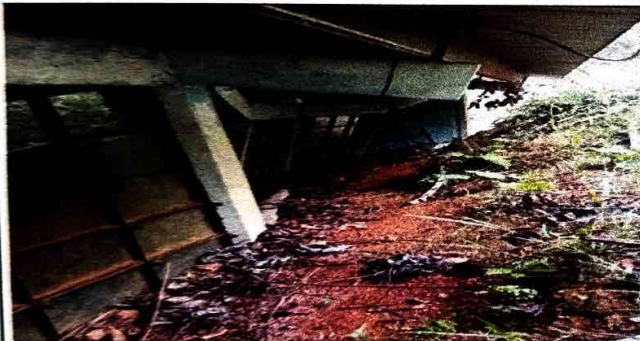
Foto 3: Se observa que tanto está dañada el aula no. 1 por la tierra derrumbada.
